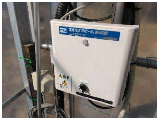
散水設備（制御盤）
