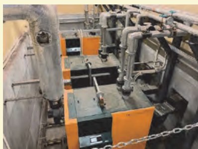
介護施設に導入されたボイラー
