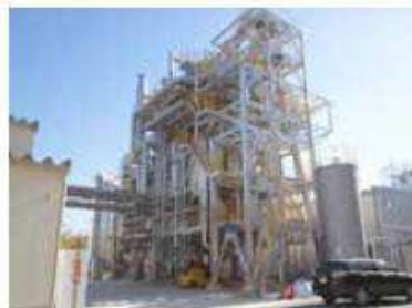
トラベリングストーカボイラー 燃料を燃焼させて蒸気を生産させます。
