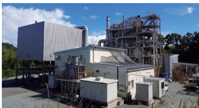
松阪木質バイオマス発電所プラント
