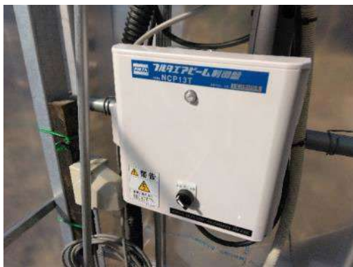
散水設備（制御盤）
