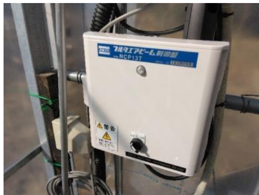
散水設備（制御盤）
