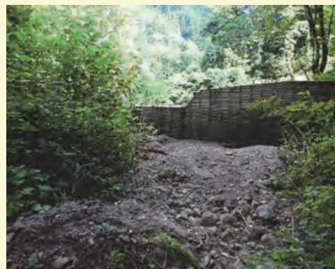
令和6年7月25日からの大雨後の状況 (No.1治山ダム上流側)
