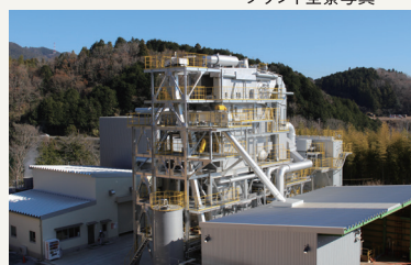
バイオマスパワーテクノロジーズ発電所(2号機)プラント全景写真
