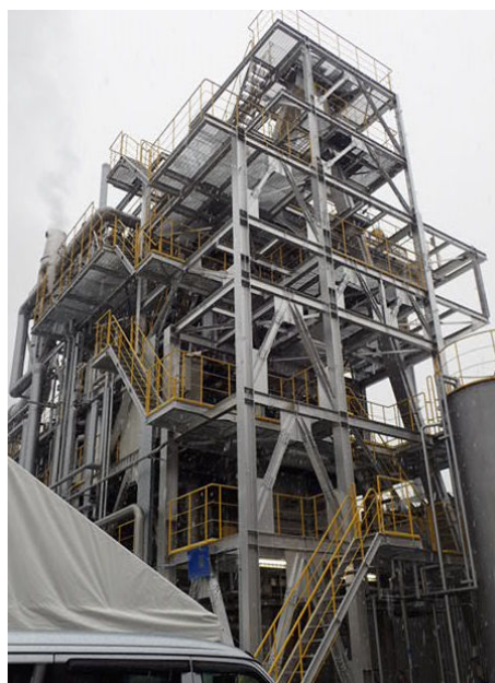
2MW級といえども、プラントの架構は5MW級にも匹敵する存在感
