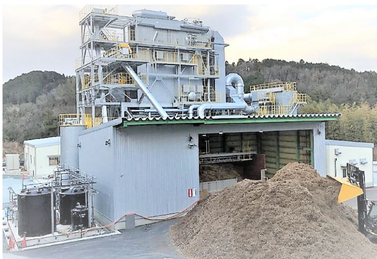
試運転開始後、燃料チップも順調入荷している(提供:BPT社)
