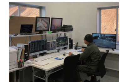
中央制御室 ボイラー及びタービン発電機その他補機類を管理制御します。
