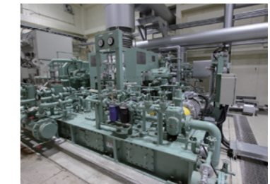
蒸気タービン・発電機 ボイラーから発生した蒸気を利用して発電を行います。
