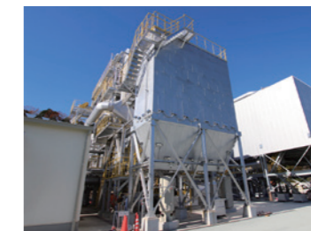
バグフィルタ 排ガス中の煤塵などを除去しクリーンな排ガスにします。
